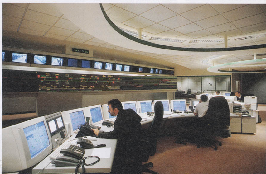
Depuis 1998, date de mise en service de Météor (ci-dessus, son centre de commandes centralisé), les logiciels sécuritaires du métro automatique parisien, développés à l'aide des méthodes formelles, n'ont connu aucune défaillance.
